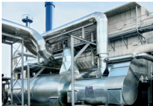
Abluftanlage mit Wärmerückgewinnungssystem der Dürr AG
